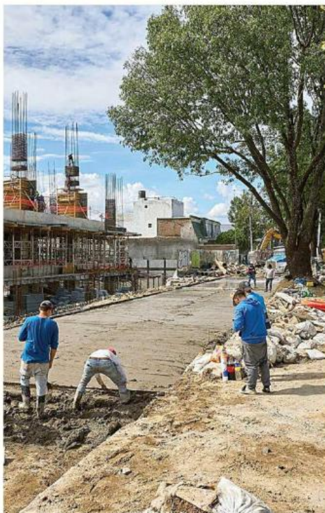
■ El socavón se generó el domingo sobre la lateral de López Mateos, a su cruce con la Calle Pléyades.
