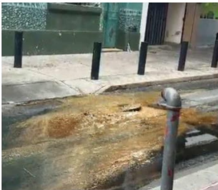
Denuncian fallas. CORTESÍA: LOCATARIOS DE MEXICALTZINGO
