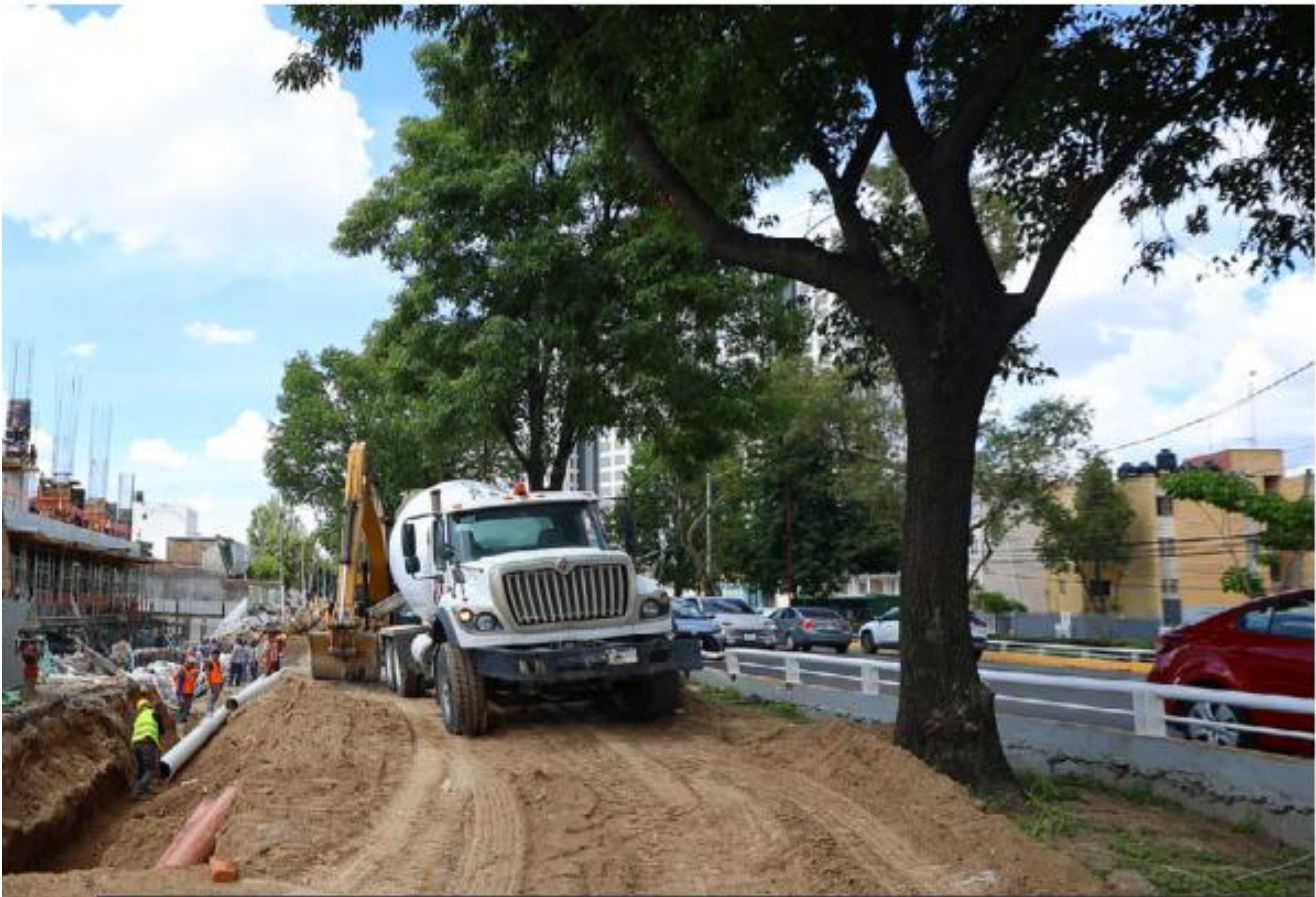
El gobierno zapopano atendió el socavón del 14 de junio en la lateral de López Mateos; este Ayuntamiento reconoció que forma parte de la lista de deudores. CORTESÍA: GOBIERNO DE ZAPOPAN
