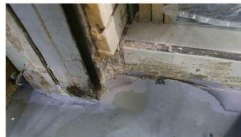
Los locatarios señalaron que algunos desperfectos se cubrieron con pintura.
