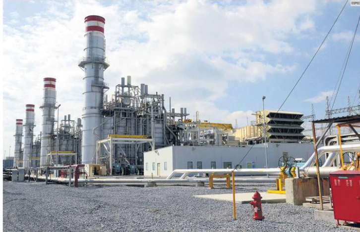
PROYECTO. Una planta de ciclo combinado genera electricidad mediante una turbina de gas y otra de vapor, aprovechando dos veces la energía del combustible. Su eficiencia es mayor y sus emisiones son menores que las plantas que utilizan carbón o combustóleo. La CFE apuesta por ésta porque permite producir electricidad de manera continua, flexible y confiable, además de respaldar a las energías renovables. En la imagen, la central de ciclo combinado Dulces Nombres II en Pesquería (cerca de Monterrey), Nuevo León.
