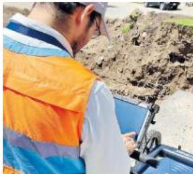
ASFALTO. El hundimiento es revisado con georradar.
