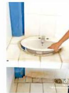
En un video se observan la condición del lugar.
