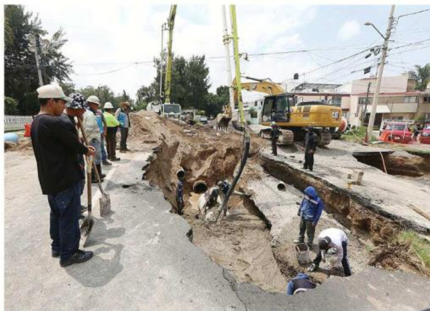
■ Se estimaba que la reparación del socavón de Enrique Díaz de León tardaría tres semanas, y la de Malecón entre tres y cinco semanas.
