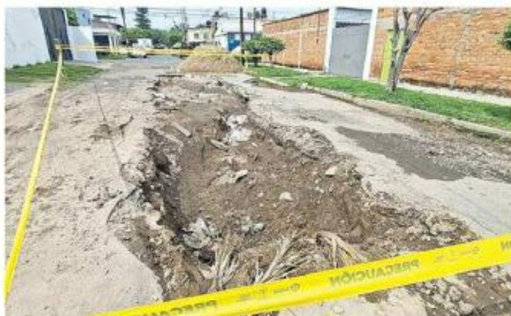
■ El socavón tiene cerrada la vía, a la altura de Volcán Jorullo, lo que complica la movilidad en El Colli Urbano.
