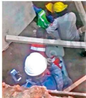
El accidente se dio en una obra en construcción. CORTESÍA
