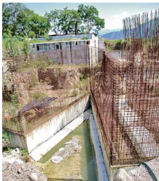
Las obras están abandonadas desde 2016; con el temporal hay charcos que fomentan la reproducción del mosquito.
