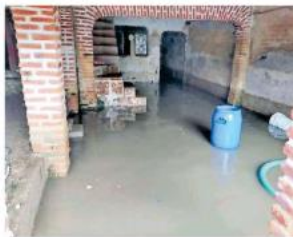
Vecinos limpiaron por horas los daños de la intensa lluvia.
