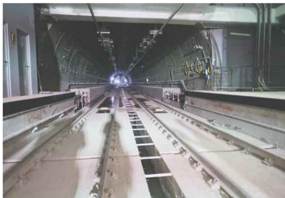
DESCOMPOSTURA Recientemente se dieron a conocer fallas en las dovelas del túnel de la Línea 3.
