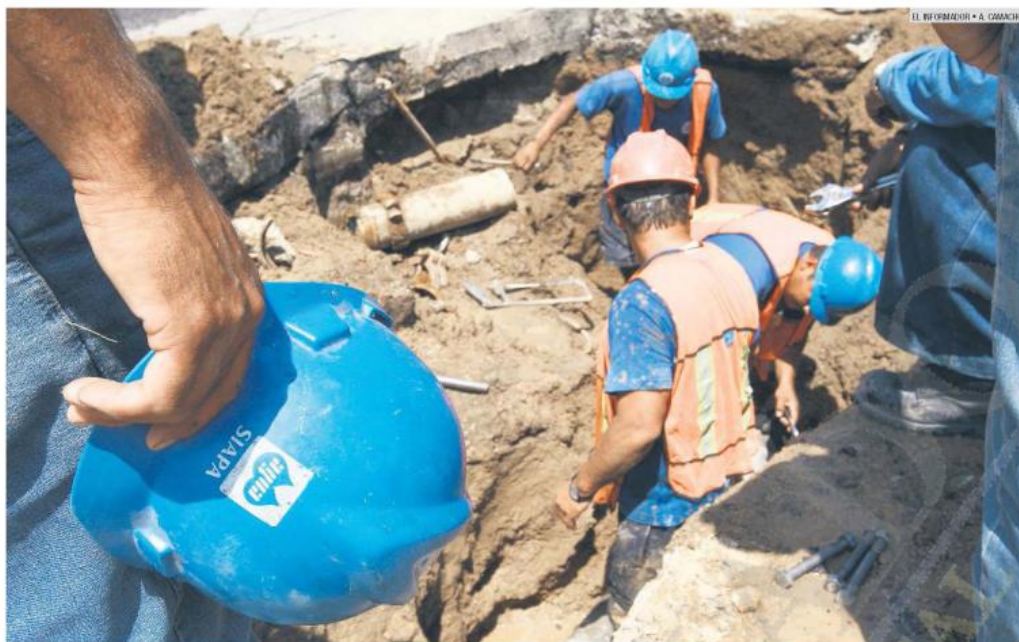
RENOVACIÓN. Una cuarta parte de las líneas de agua de la Zona Metropolitana de Guadalajara necesita ser renovada, al tener una antigüedad de hasta 50 años.
