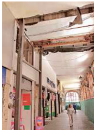
■ Portales del edificio frente a Plaza de Armas se apuntalaron por daños de obra de L3.
