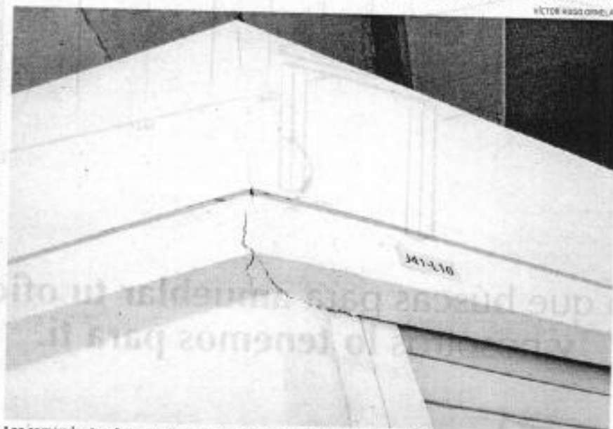
Los comerciantes desconocen la gravedad de las fisuras en sus espacios
