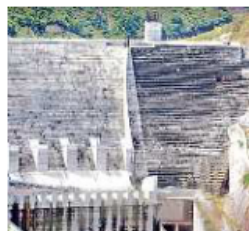
Según Alfaro, no se detendrá o derrumbará la cortina.
