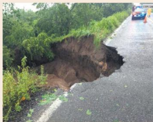
RIESGO. En la Carretera 80 Guadalajara-Barra de Navidad cerraron la circulación entre los poblados de La Paz y La Huerta.
