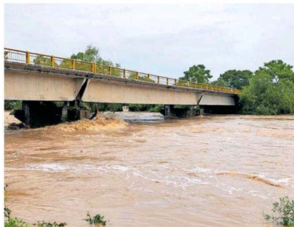
El agua estuvo a punto de sobrepasar el nivel del puente.
