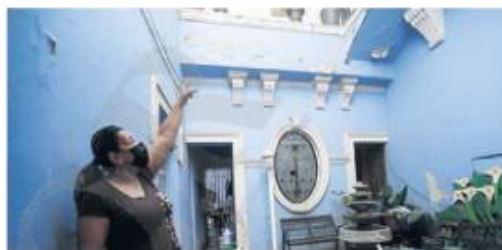
HOSPITAL. Esta finca tiene grietas y hundimientos en pisos.
