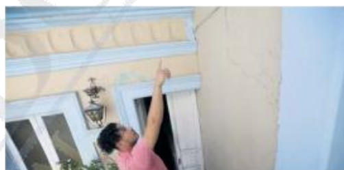
SALDO. Suman 12 inmuebles con afectaciones tras las obras de la Línea 3.
