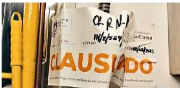
■ El Gobierno de Guadalajara realizó una clausura parcial al sistema de extracción del inmueble.
