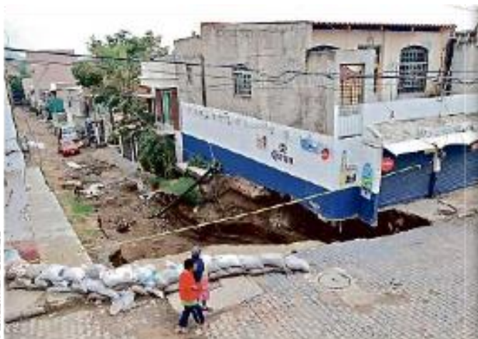
■ Finca ubicada en el cruce de Puerto Chamela y Costa grande que quedó con el suelo erosionado.
