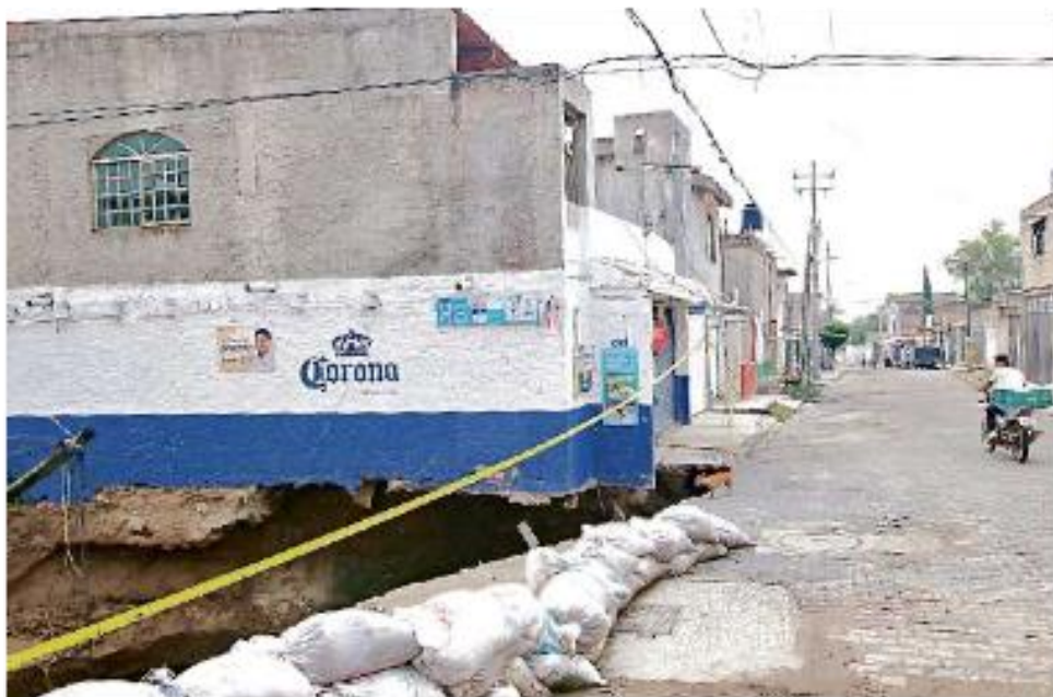
■ Varias casas quedaron inhabitables tras el desbordamiento del Arroyo El Seco.
