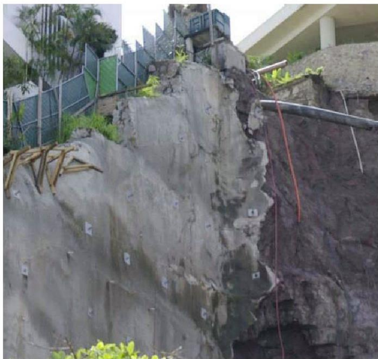
El incidente dañó instalación eléctrica y de agua potable. CORTESÍA TRIBUNA DE LA BAHÍA
