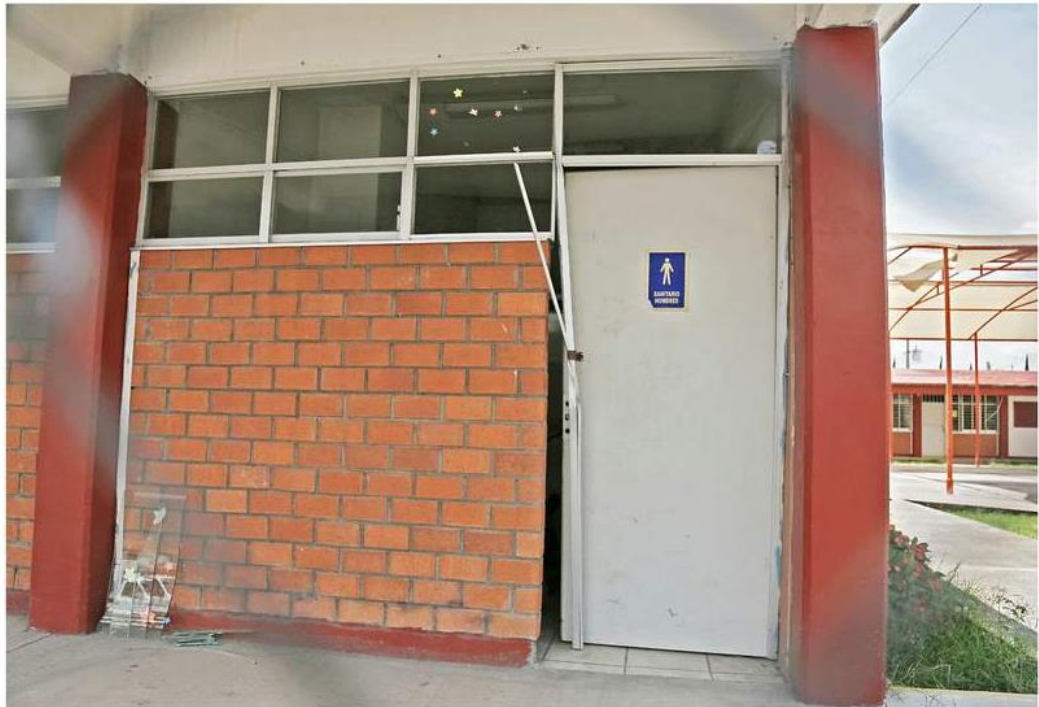
■ 217 planteles de educación básica sufrieron daños de mayor gravedad en su infraestructura.
