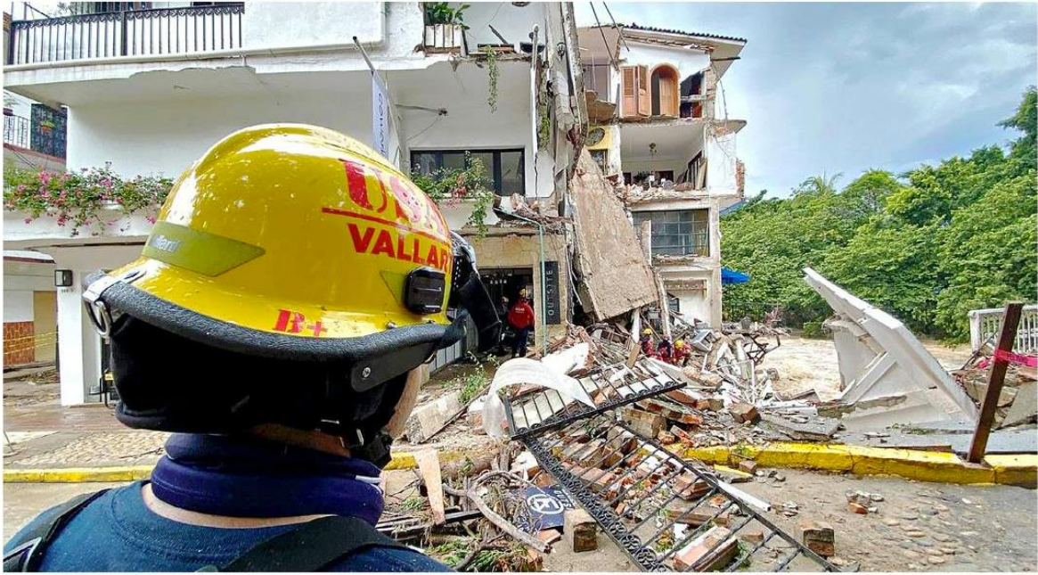
El desbordamiento de los ríos Cuale y Pitillal causaron el derrumbe de inmuebles y afectación a locales.
