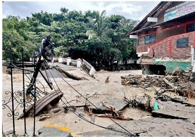
■ En Puerto Vallarta se desbordaron los ríos Cuale y Pitillal, provocando el derrumbe de infraestructura.
