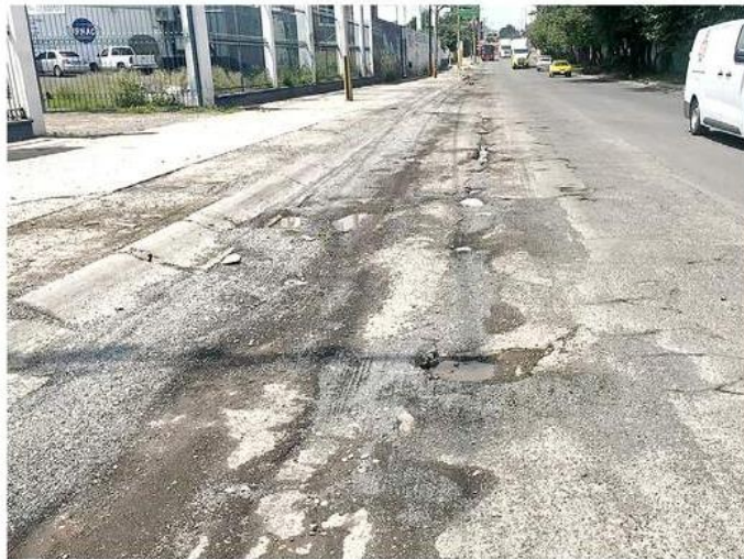
■ En un tramo de Avenida Lázaro Cárdenas, entre Álamo Industrial y Nodo Revolución, la obra de rehabilitación quedó inconclusa.
