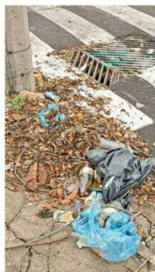
■ Algunas alcantarillas de la Ciudad están en riesgo de taparse por la acumulación de basura.
