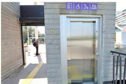
■ En la estación Centro Cultural Universitario el elevador se encuentra fuera de servicio.
