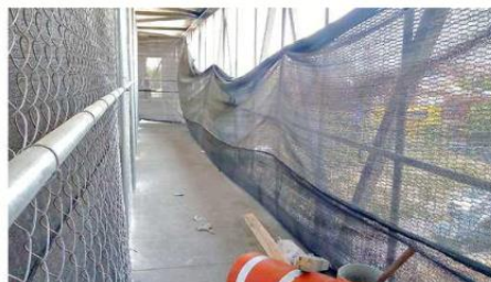
■ Estación Periférico Norte no tiene elevadores instalados y en el puente peatonal hay una área con malla ciclónica.
