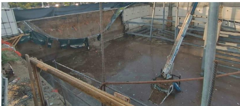
El colapso se registró en el cruce con Jesús García y Sarcófago, en la zona Centro de Zapopan. ESPECIAL
