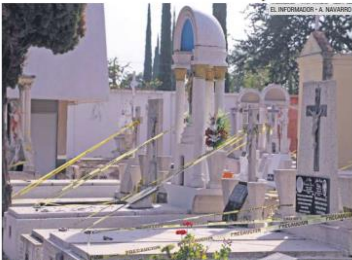
DETERIORO. En el Panteón de Mezquitán se colocó cinta de precaución para alertar a los visitantes sobre las tumbas que se encuentran en mal estado.
