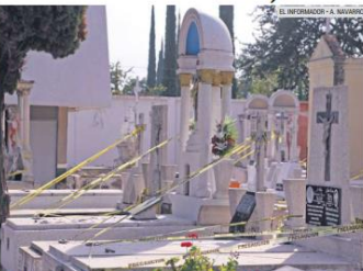
DETERIORO. En el Panteón de Mezquitán se colocó cinta de precaución para alertar a los visitantes sobre las tumbas que se encuentran en mal estado.
