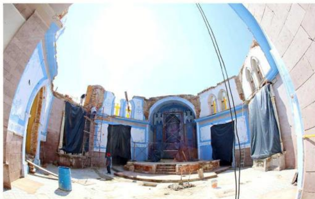
■ Cultura Jalisco aportó 6 millones de pesos para la reconstrucción de la cúpula de la Parroquia de Nuestra Señora del Pueblito, en San Juanito de Escobedo, que colapsó el 20 de septiembre de 2021.
