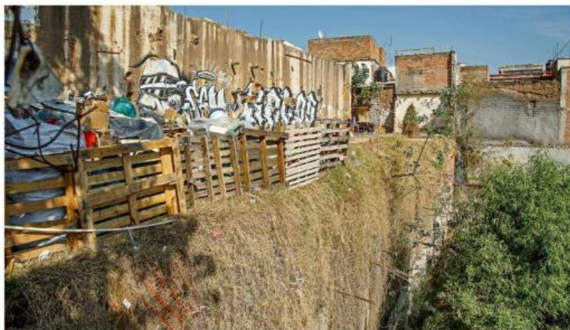
Debido a los daños estructurales, una finca fue demolida.
