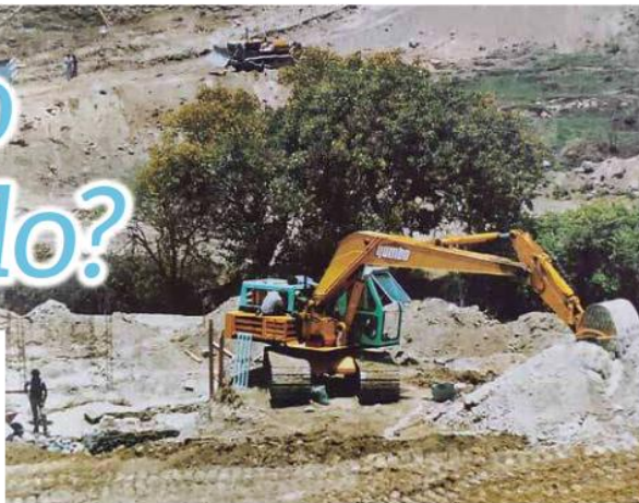
• La administración municipal 1986-88 cedió más de 40 hectáreas a la iniciativa privada para empezar la construcción (foto) del Zoológico Guadalajara en la enorme extensión patrimonial de Huentitán el Bajo.
