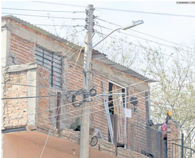
RIESGO. En varias colonias de la Zona Metropolitana de Guadalajara es común observar instalaciones irregulares en postes de energía eléctrica.
