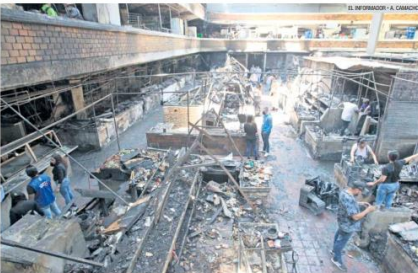
DESOLACIÓN. El incendio en el Mercado Libertad de marzo de 2022 afectó a 426 locales.
