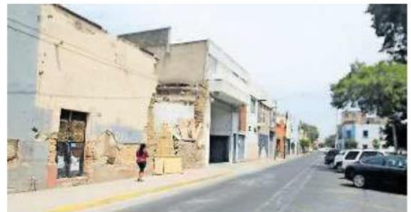
Muchas son las viviendas que están a punto del derrumbe.
