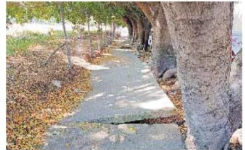
Banquetas destruidas por árboles que crecen sin control.
