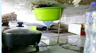
■ Por las goteras, un locatario colocó un recipiente colgado del techo, para captar el agua, y le instaló una manguera como desagüe hacia el drenaje.
