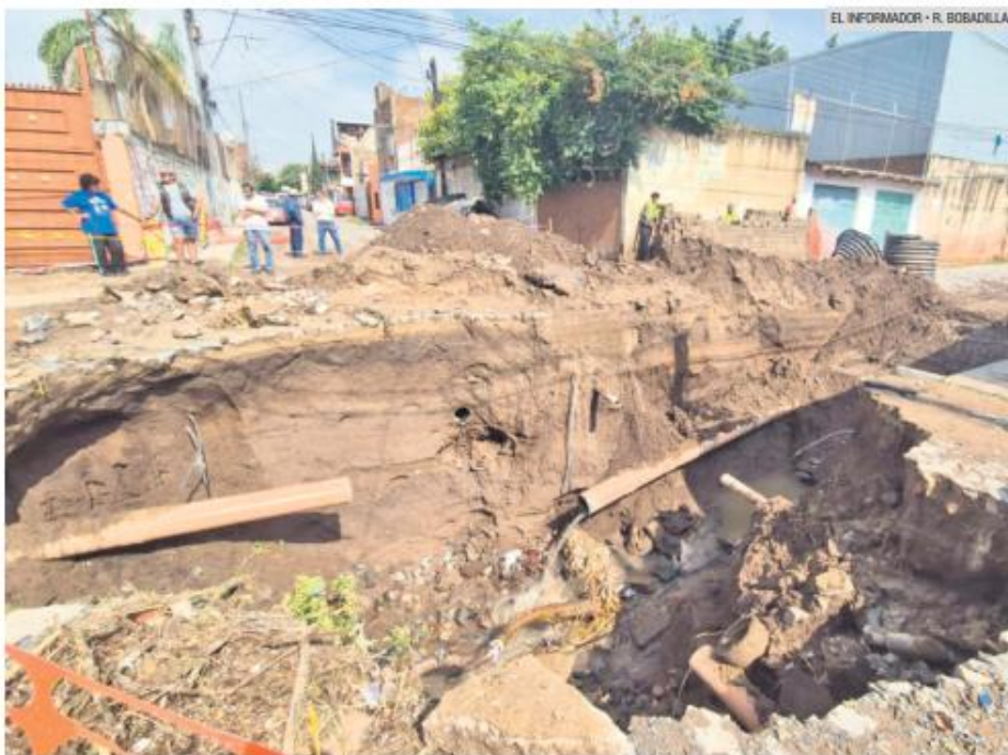
RIESGO. Socavón de 12 metros en la colonia La Duraznera pone en evidencia el deterioro de la red de drenaje en Tlaquepaque; el Gobierno estatal exige al SIAPA una renovación urgente de la infraestructura.
