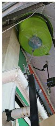
■ En la Cremería San Juan se improvisó un sistema para captar el agua que gotea del techo durante las lluvias.
