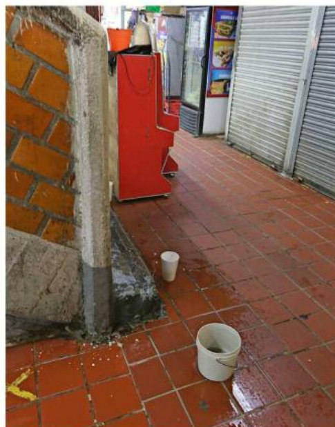
■ Locatarios colocan botes y cubetas en los pasillos del mercado para evitar accidentes de usuarios.
