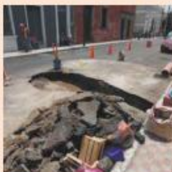
HOYO. En Garibaldi y Mariano de la Bárcena hay un gran socavón que ayer era atendido por personal del Siapa.
