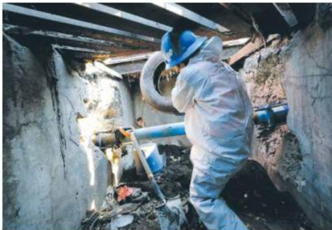
EN PUNTOS CRÍTICOS. El mandatario llamó a sustituir las tuberías en las zonas de mayor riesgo.
