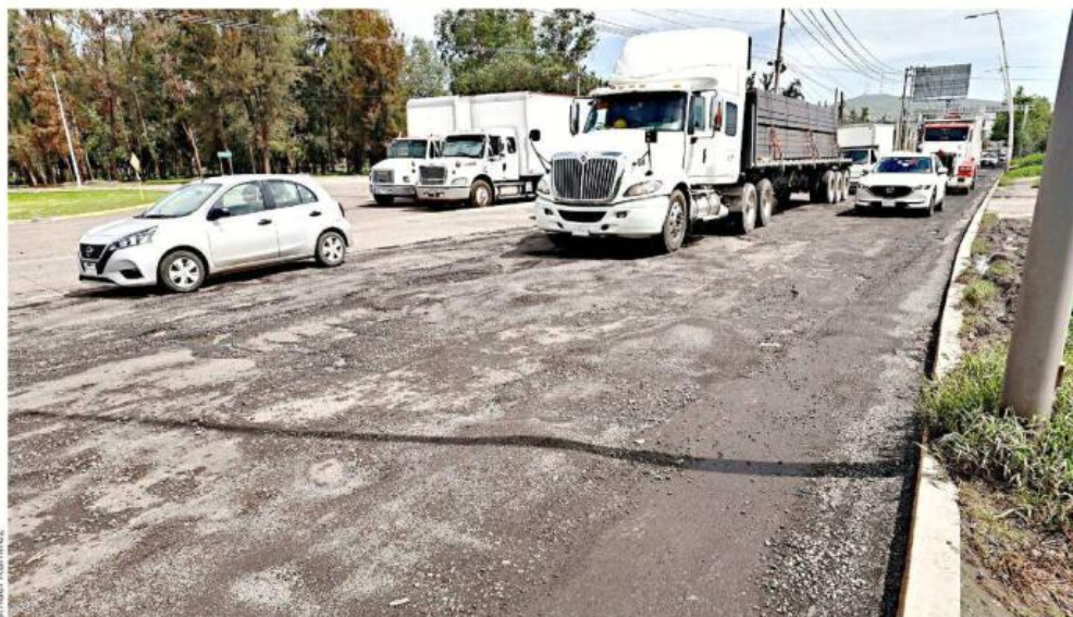
■ Pese a que el Ayuntamiento trabaja para mejorar la Avenida Adolf Horn, los baches y las obras dificultan el tránsito.
