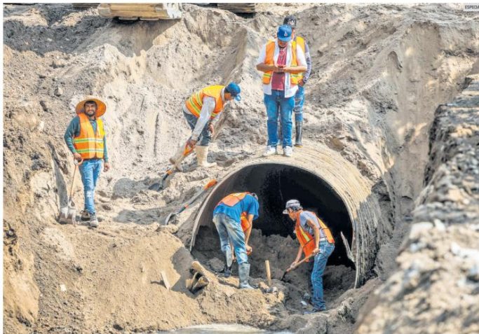
RIESGO. Trabajadores de la SIAPA realizan reparaciones en un socavón en una zona del Oriente de Guadalajara, donde las redes de drenaje tienen hasta 90 años de antigüedad y presentan un alto riesgo de colapso por falta de mantenimiento.
