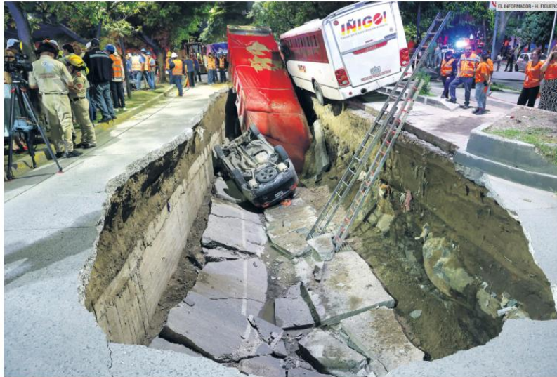
RIESGO. Hace unos días, el colapso de un colector pluvial generó un socavón que dañó vehículos en la Avenida Malecón, en Guadalajara.
