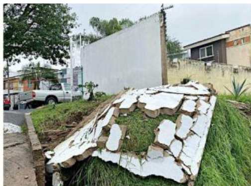
■ Tras la lluvia registrada hace dos semanas, colapsó el muro de una vivienda ubicada en Parques del Bosque.
