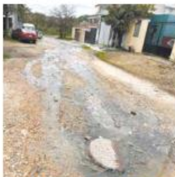
QUEJA. La descarga de aguas residuales se dirige a la zona del bosque.
