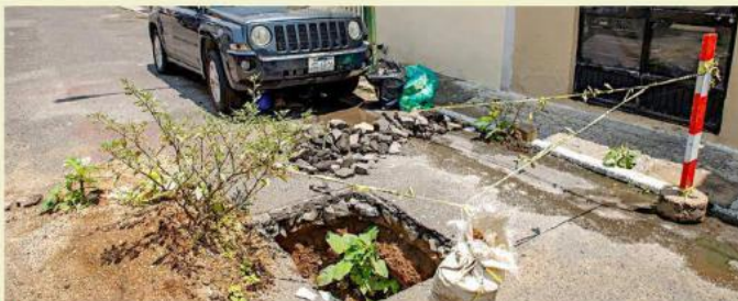
Sobre Fernando Espinoza fue reparado un socavón, pero dejaron escombros y surgió otra agujero.
