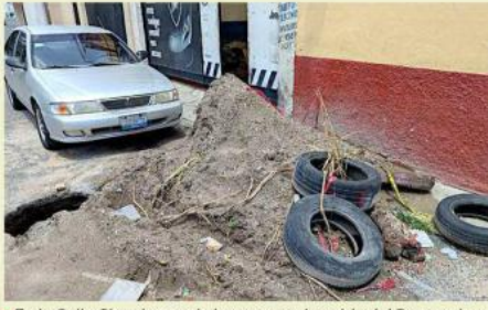
En la Calle Ciencias, casi al cruce con Avenida del Parque, hay un socavón rodeado de tierra y llantas.
