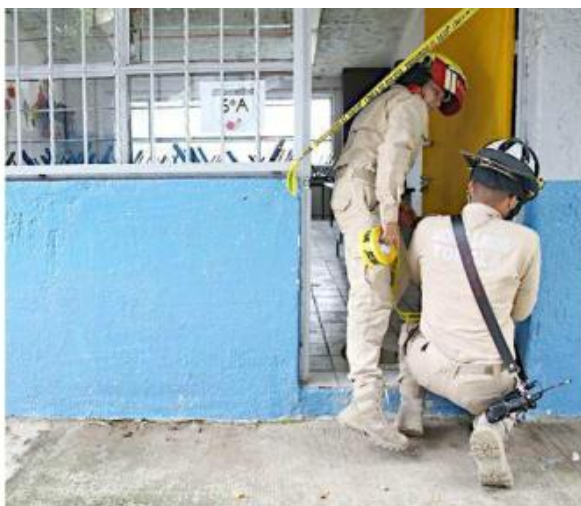
■ Presenta daño estructural la primaria "Magdalena Vidaurri", ubicada en la Colonia Loma Dorada, en Tonalá.
