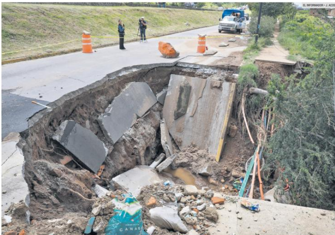
AFECCIÓN. El socavón mide cinco metros de profundidad y se abrió en la Avenida Reyes Heróles, en la Colonia Valentín Gómez Farías. Trabajadores del Ayuntamiento y del SIAPA laboran para rehabilitar la zona.
