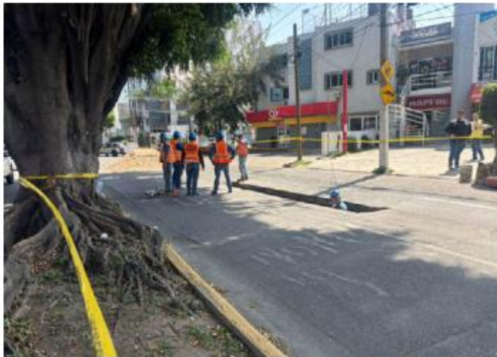
SOCAVÓN. Enorme desperfecto se generó ayer lunes en los cruces de las calles Naciones Unidas y Dante Alighieri, en Zapopan. Personal de SIAPA acudió al llamado de vecinos a reparar.
