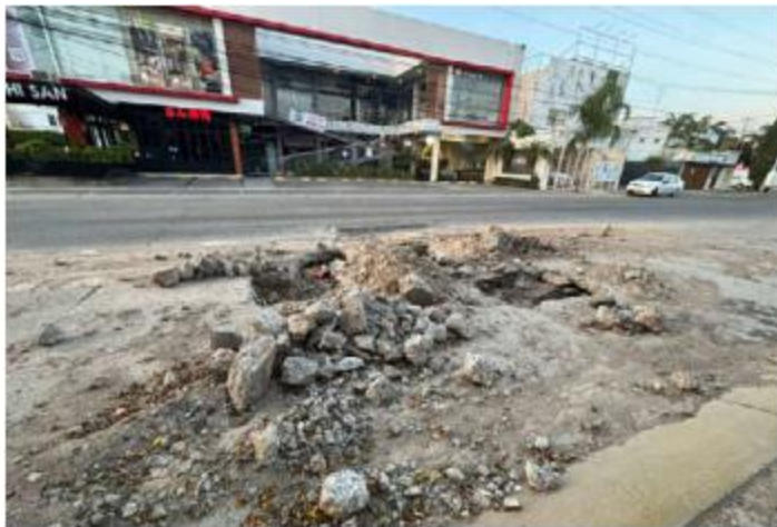
VIALIDAD. Sobre las calles San Juan Bosco y Contadores, en la colonia Residencial Cordilleras de Zapopan, vecinos reportan el hundimiento de parte de la vialidad, para evitar tragedias.
