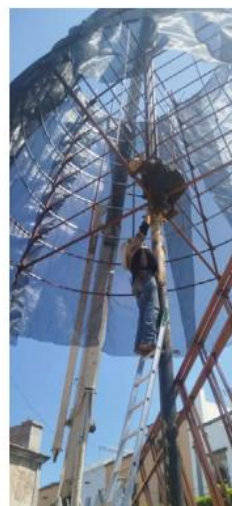
Las labores siguen. CORTESÍA
