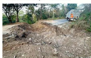
Para impedir el paso de patrullas tras los operativos, el CJNG optó por dañar carreteras con maquinaria pesada.
