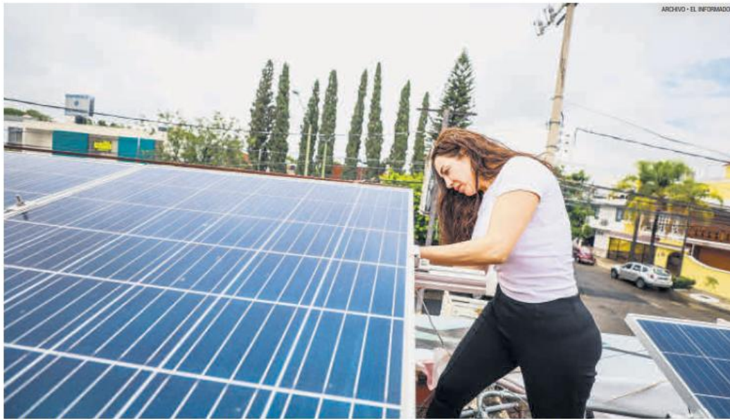
TECNOLOGÍA. Una mujer instala un panel solar en un sistema fotovoltaico, como parte del impulso a la generación de energía limpia.
