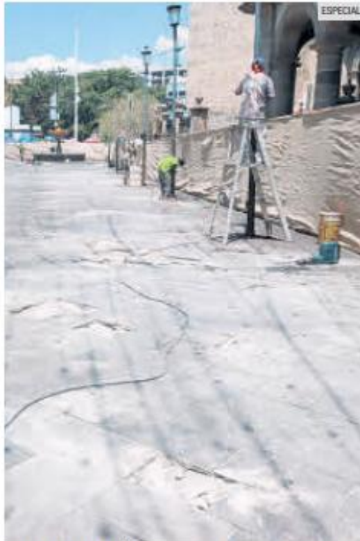
REHABILITACIÓN. La explanada es uno de los principales focos de atención de las obras.
