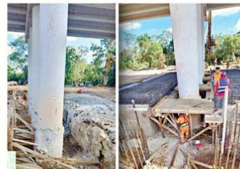
Trabajos de apuntalamiento intentan frenar el hundimiento de pilotes del Tren Maya.
