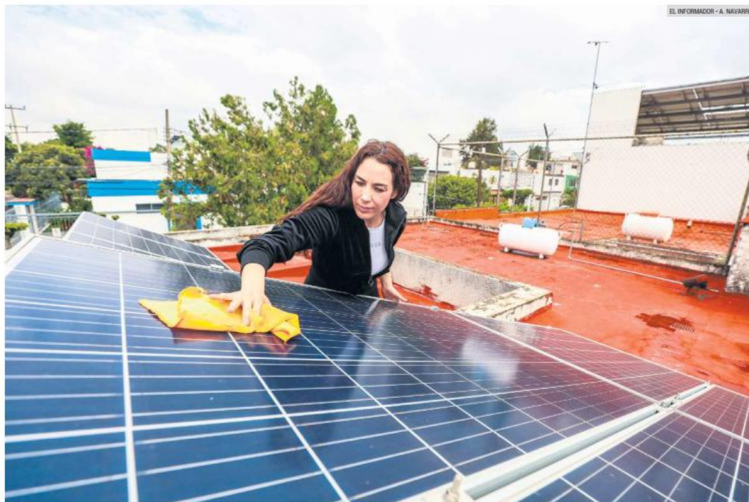
OPCIÓN. Una mujer realiza labores de limpieza en paneles solares instalados en una azotea, para optimizar su eficiencia energética.
