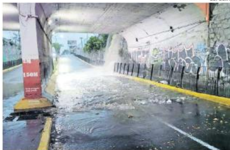
DE NUEVO INUNDADO. El paso a desnivel de la avenida 8 de Julio y Washington registró una acumulación de agua cercana a los 40 centímetros.
