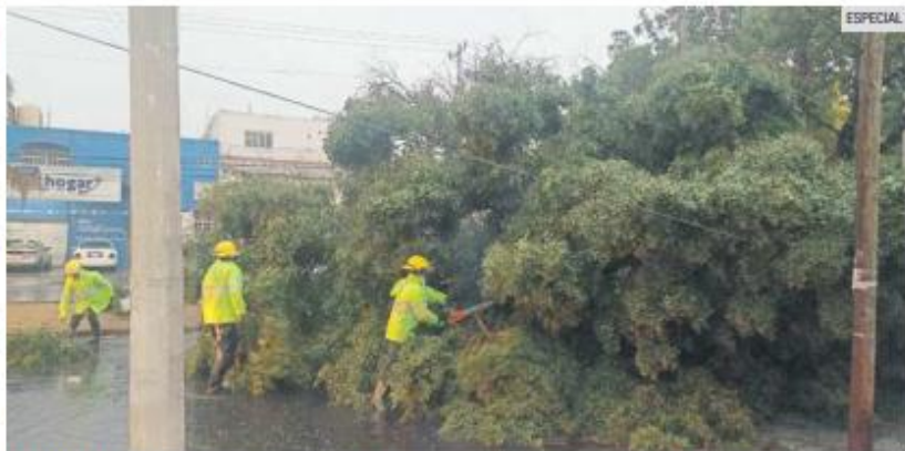
COMPLICACIONES. La caída de los árboles generó afectaciones a la circulación.
