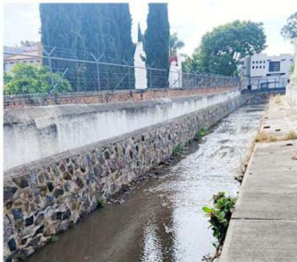
Vecinos temen que las aguas negras del canal terminen en el nuevo vaso regulador.
