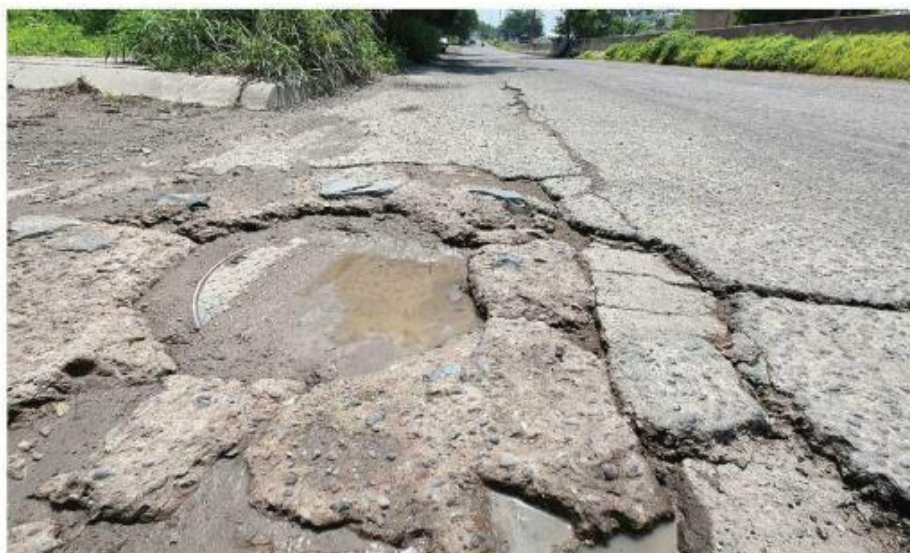
■ En la vía es notable el deterioro, como los baches, que con las lluvias no se perciben.
