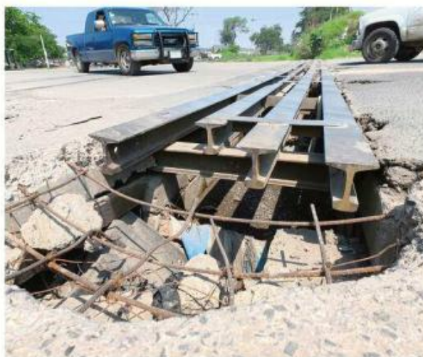
■ Una boca de tormenta presenta daños, lo que se ha convertido en un riesgo para los conductores.
